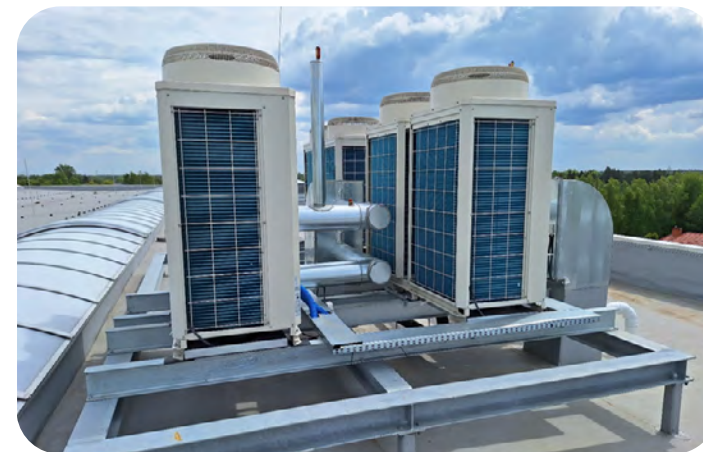
Pompy ciepła zainstalowane w nowym magazynie w Radzyminie
